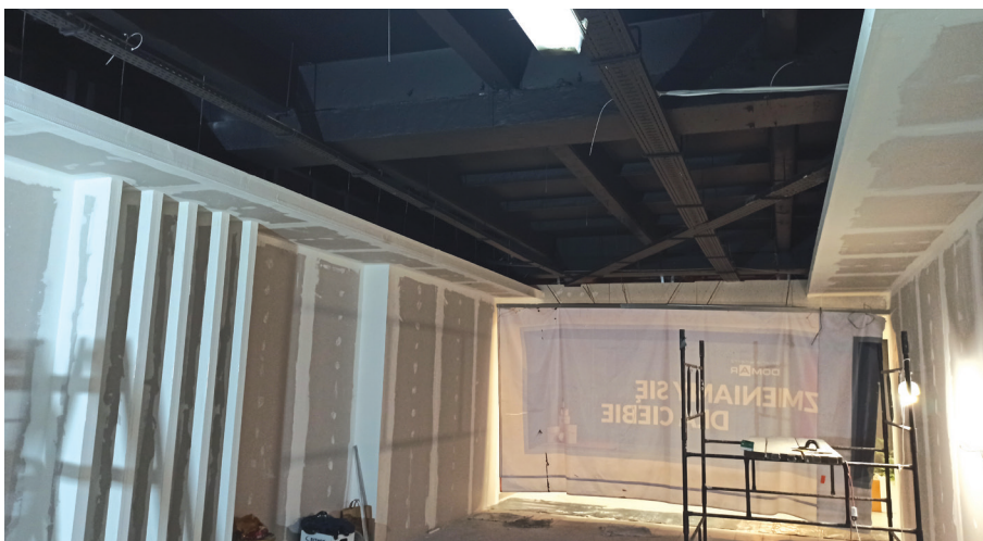
Pomieszczenia przeznaczone na showroom Korner Design w trakcie remontu , w Galerii Handlowej Domar we Wrocławiu.
