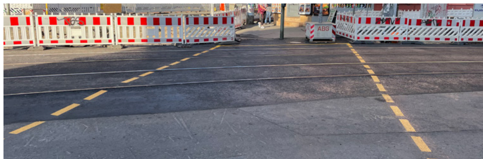
80. Tymczasowe przejście dla pieszych w Berlinie wytyczone na czas remontu ulicy
