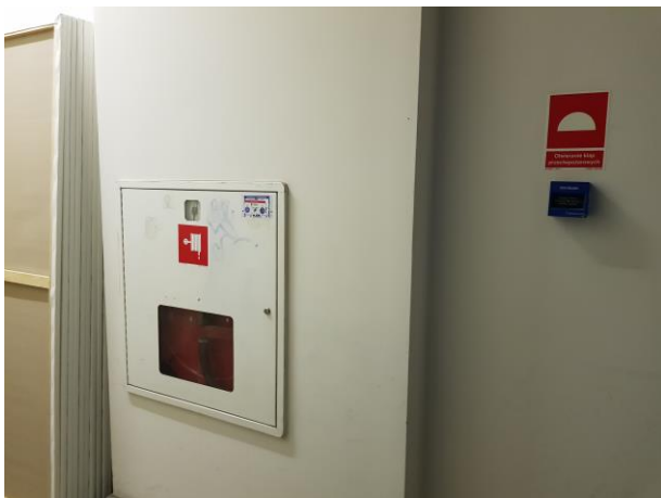
Widok usytuowania hydrantu wewnętrznego
