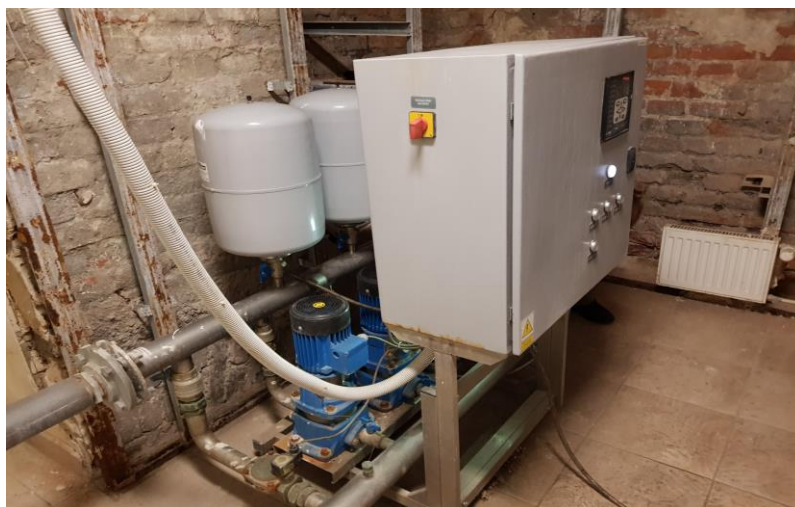
Widok jednej z pompowni do podtrzymania ciśnienia w wewnętrznej sieci hydrantowej
