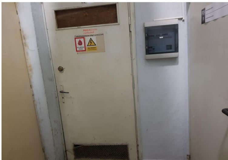
Wejście do rozdzielni głównej instalacji elektrycznej
