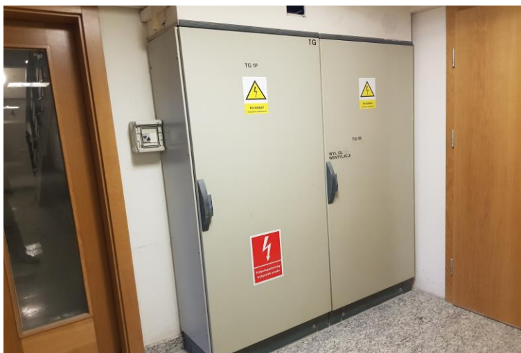
Przeciwpożarowy wyłącznik prądu
