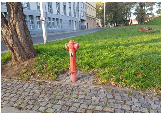
Widok hydrantu nadziemnego od strony ul. Purkyniego
