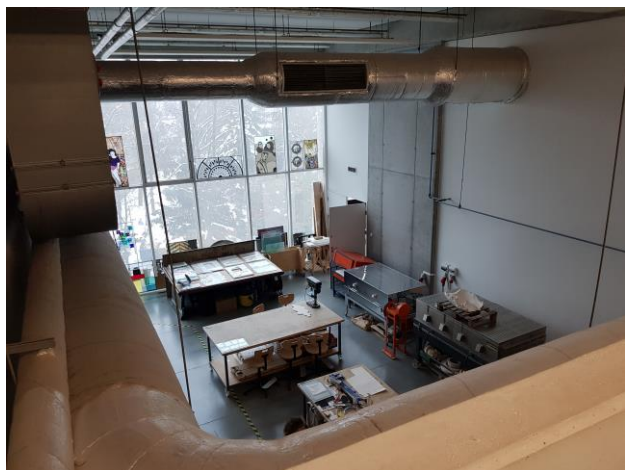
Widok systemu wentylacji mechanicznej w pracowni
