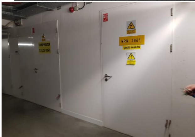
Rozdzielnie elektroenergetyczne w poziomie piwnic
