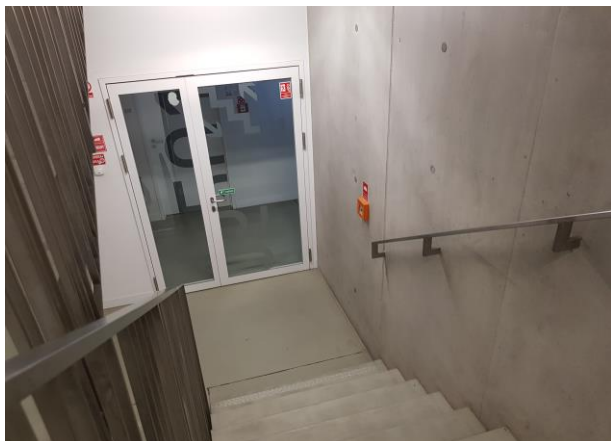
Widok drzwi przeciwpożarowych wydzielających klatki schodowe od korytarzy
