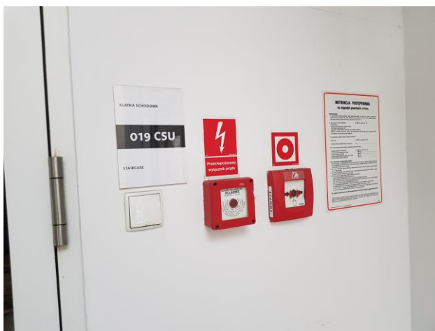
Widok usytuowania przeciwpożarowego wyłącznika prądu i ręcznego ostrzegacza systemu SSP – ROP, przy wejściu od strony dziedzińca.
