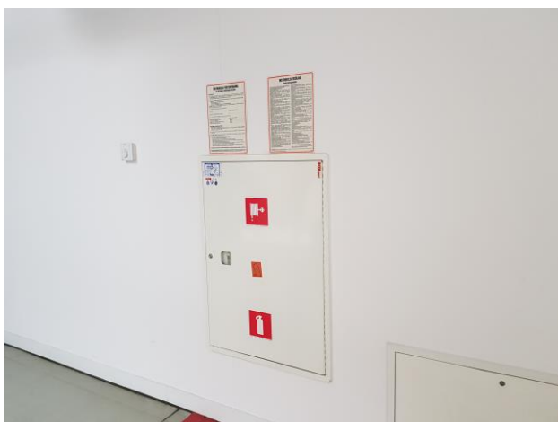
Widok szafki z podręcznym sprzętem gaśniczym – hydrant 25 i gaśnica.
