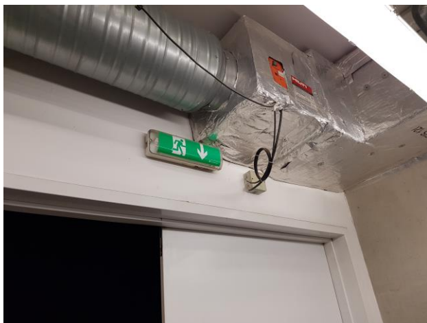
Widok lampy oświetlenia ewakuacyjnego oraz zabezpieczenia przejścia ppoż. systemem Hilti w kanale wentylacyjnym
