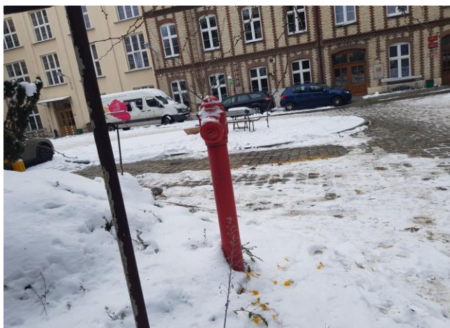
Widok hydrantu zewnętrznego, nadziemnego.
