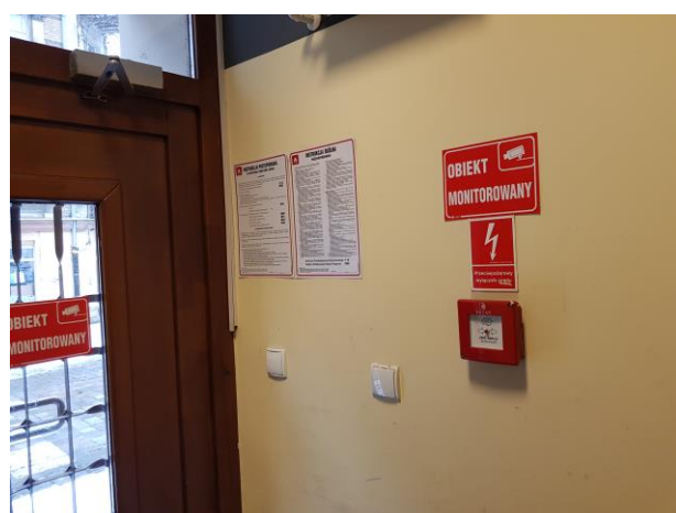
Przeciwożarowy wyłącznik prądu przy wejściu głównym
