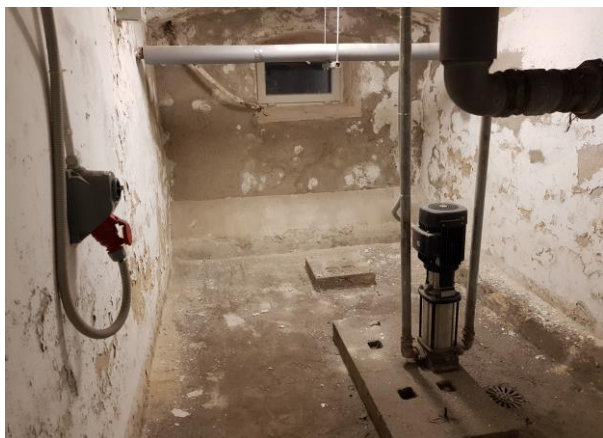
Pompa wspomagająca ciśnienie w sieci hydrantów wewnętrznych
