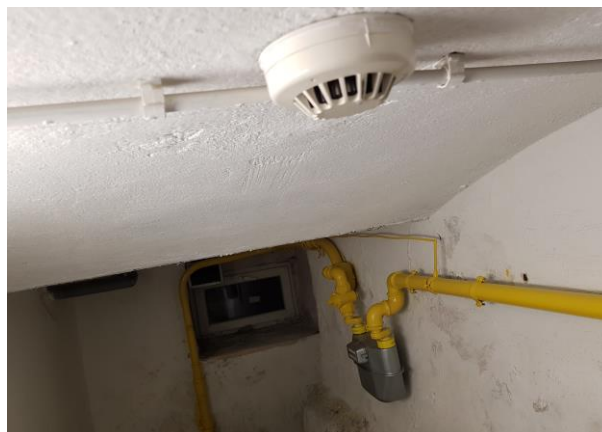
Czujka dymowa w piwnicy, W głębi główny zawór gazu
