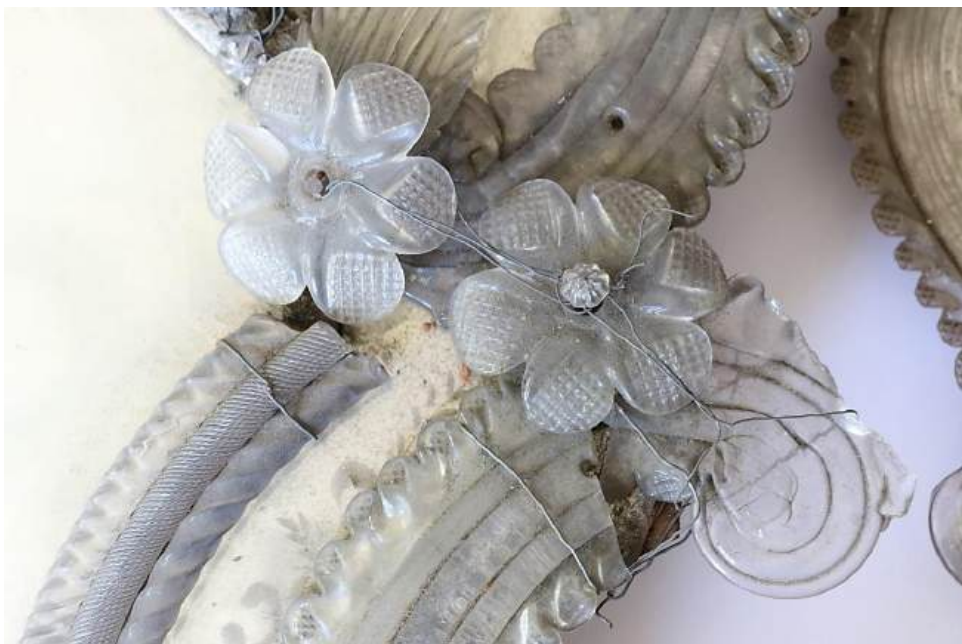
Fot. 77. Przykład niewłaściwego zabezpieczenia ruchomych elementów szklanych za pomocą drutu, Muzeum Karkonoskie w Jeleniej Górze, fot. N. Moszak
