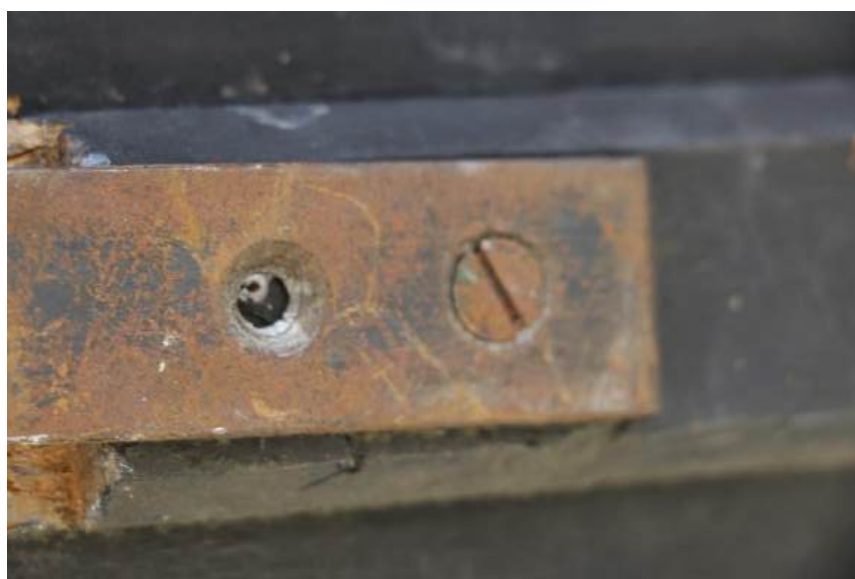
Fot. 75. Korozja żelaznego elementu montażowego, MJG 36s, fot. N. Moszak
