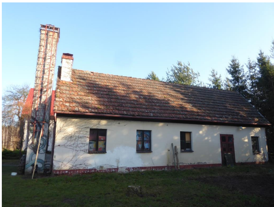
Fot. 1. Budynek gospodarczy w Luboradowie 2 z widocznym z lewej strony wolnostojącym kominem murowanym
