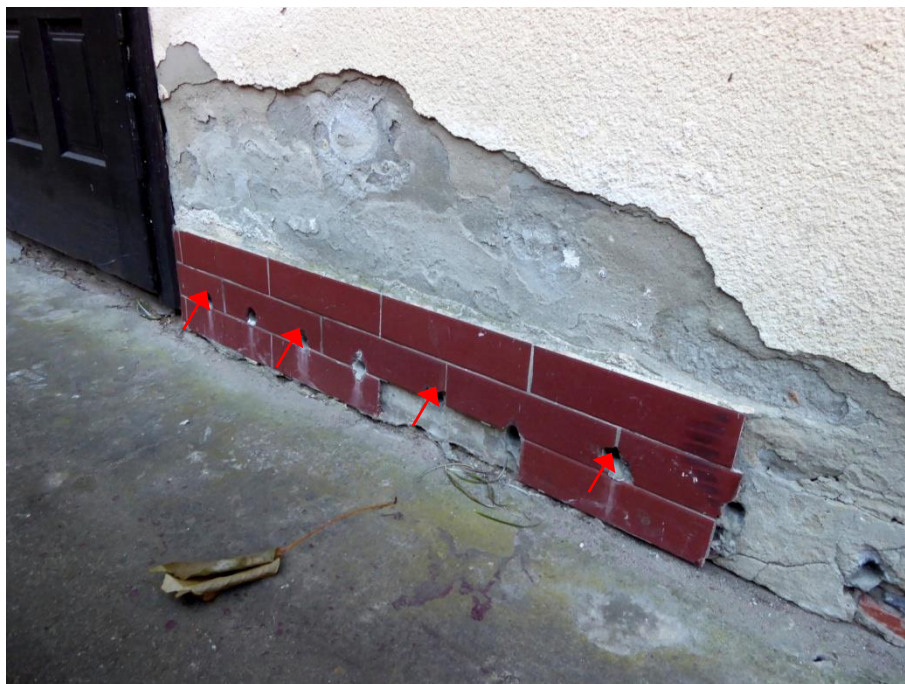
Fot. 3. Odpadające wskutek zawilgoceń i zasoleń tynki oraz otwory po wykonanych niedawno iniekcjach (oznaczono strzałkami)
