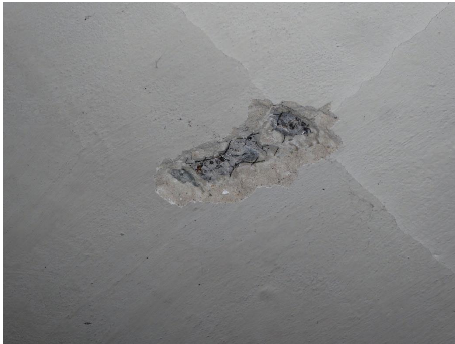
Fot. 5. Odkrywka stropu WPS w miejscu widocznym na fot. 4; widoczne zarysowanie stropu wzdłuż belki, siatka tynkarska oraz stopka belki stalowej
