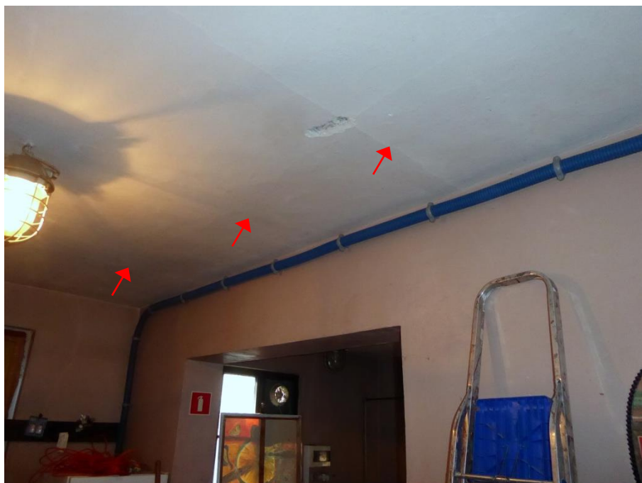
Fot. 4. Zarysowania wzdłuż belek w stropie WPS (oznaczono strzałkami) oraz miejsce wykonania odkrywki
