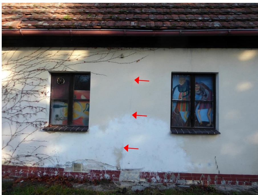
Fot. 2. Pionowe zarysowanie na elewacji budynku (oznaczone strzałkami)
